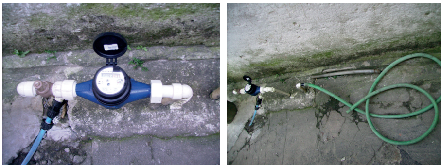
FIGURA 3 Hidrómetros y mangueras conectadas
