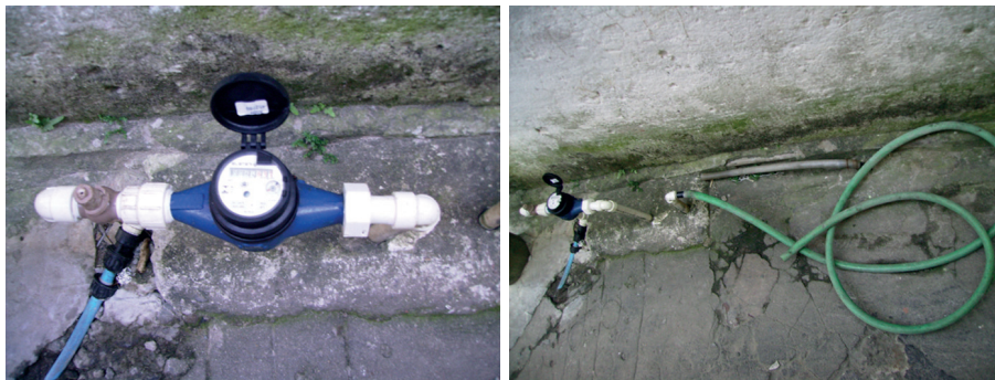
FIGURA 3 Hidrômetros e mangueiras conectadas
