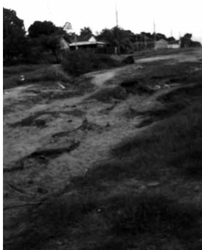
FIGURA 3 Erosão da Avenida Tropical
