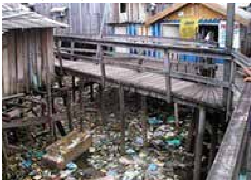
FIGURA 12 Habitação em situação de risco – Manaus (2009)
