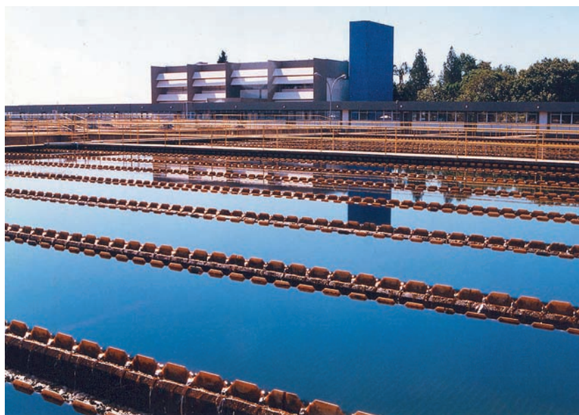
Estações de tratamento de água da Sociedade de Abastecimento de Água e Saneamento S.A. (Sanasa), de
